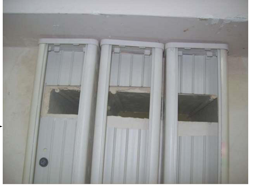
Sistem odası iç duvarı
