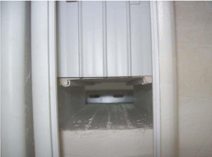
Sistem odası iç duvarı
